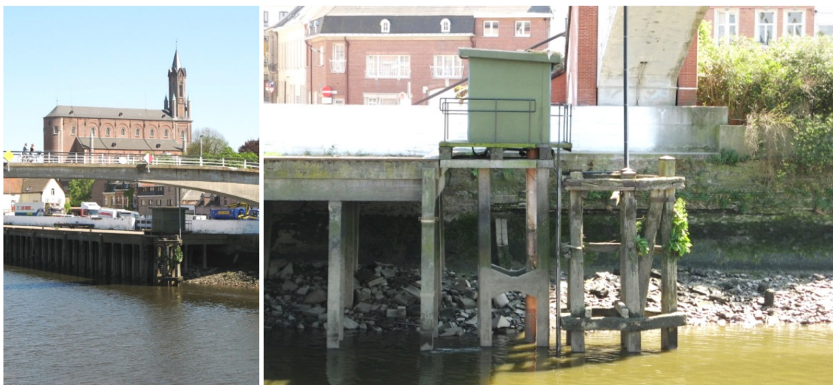
Figuur 21 - Tijmeetinstallatie te Wetteren op de Boven Zeeschelde.
