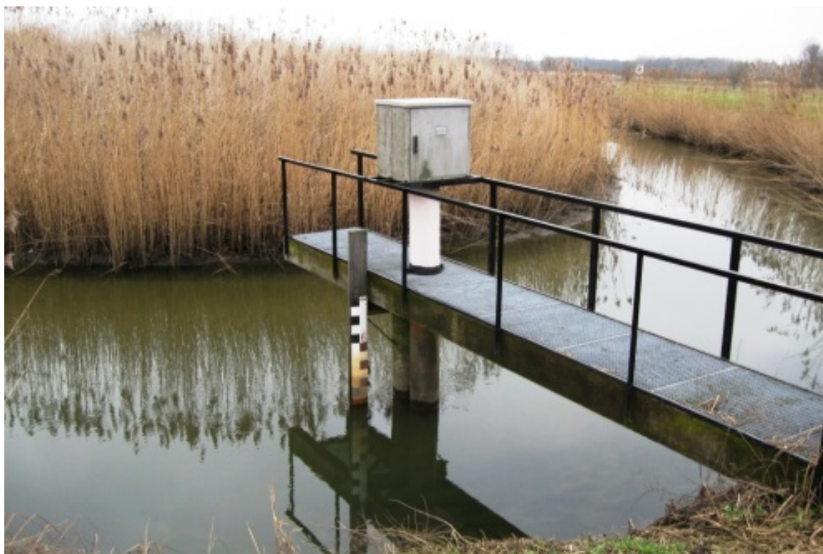
Figuur 42 - Tijmeetinstallatie te Zele op de Durme.
