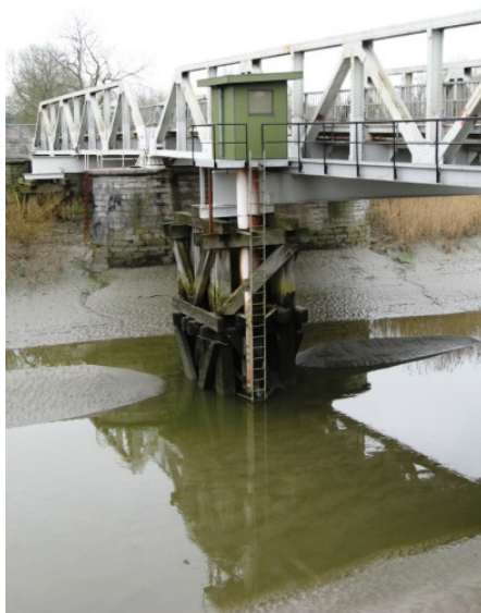
Figuur 40 - Tijmeetinstallatie te Waasmunster Brug op de Durme
