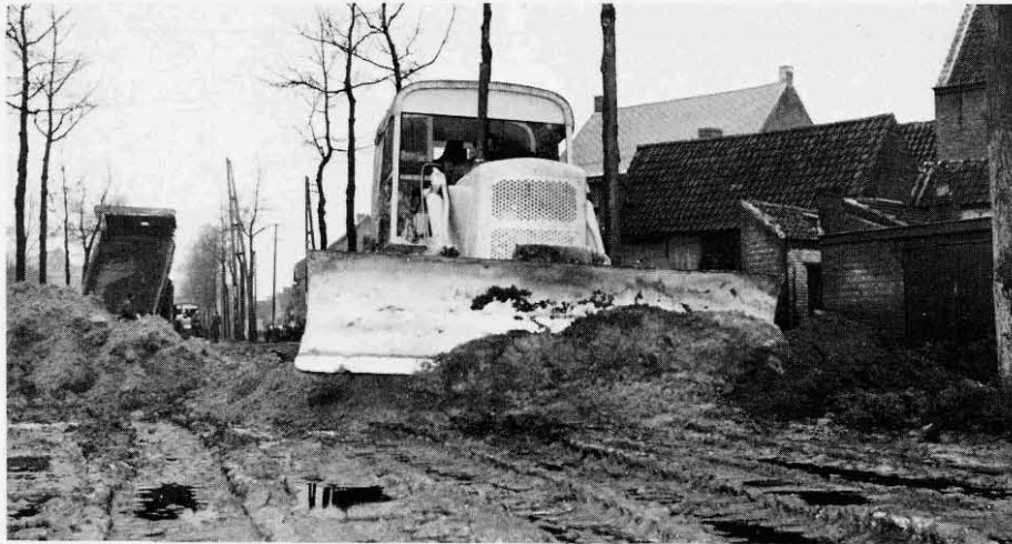
Nettoyage au bulldozer des masses de boue charriées par les flots déchainés dans les rues de Tamise.
