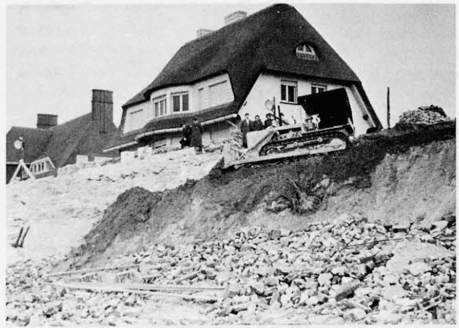
Une partie de la digue a été arrachée à Knokke-le-Zoute et les brèches durent être comblées d'urgence.
