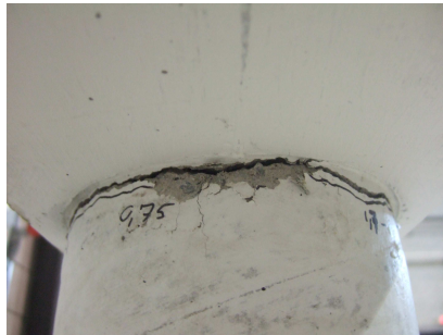
Vue du côté gauche, endommagement en compression
