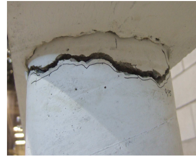
Vue du côté droit, importante ouverture de fissure
