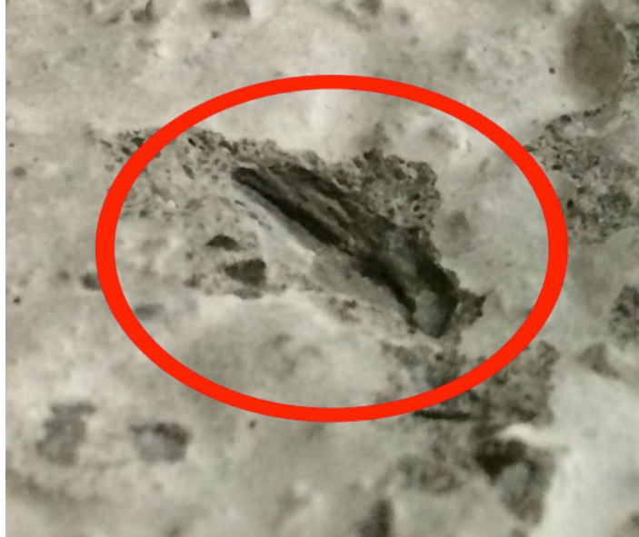
Figure 4-5 Fracture visible dans le granulat
