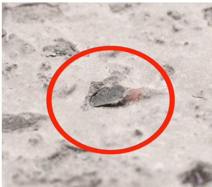
Figure 4-4 Présence de feuillets en surface due à un « pop-out »
