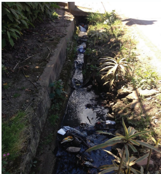
Figura 5.2. Recolectores de agua pluvial donde son vertidas aguas residuales y acumulación de residuos sólidos que son descargados por la misma comunidad.
