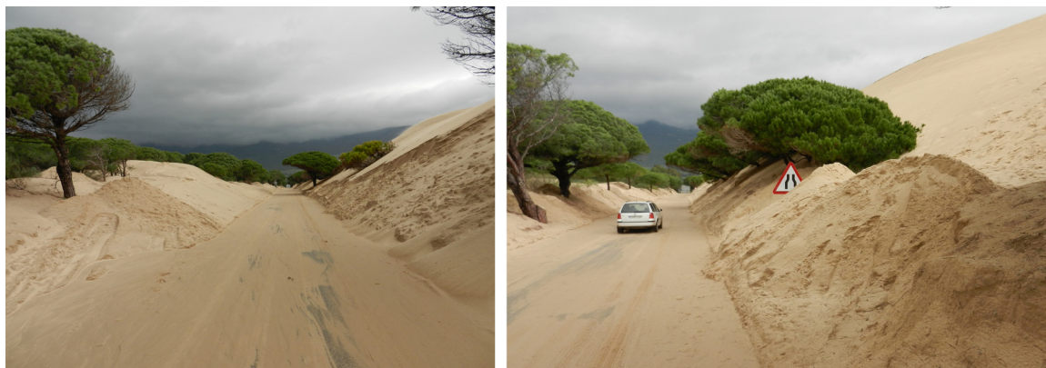
Figura 2. Carretera A-2325 el 7 de diciembre de 2012. El pavimento de la vía se encuentra cubierto de arena procedente de la duna, que ha sepultado señales de tráfico y vegetación arbórea.
