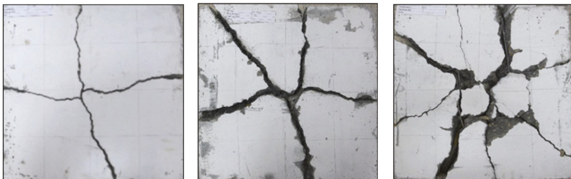
Figura 6. Esquemas de agrietamiento final de las losas: a) CS, b) D_f = 14.1 \text{ kg/m}^3 , c) CR
