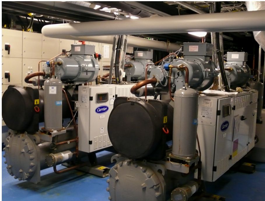
Kuva 43. TTK Tietotekniikan talon vedenjäähdytyskoneet 2 kappaletta yhteiseltä sähköteholtaan 400 kW.
