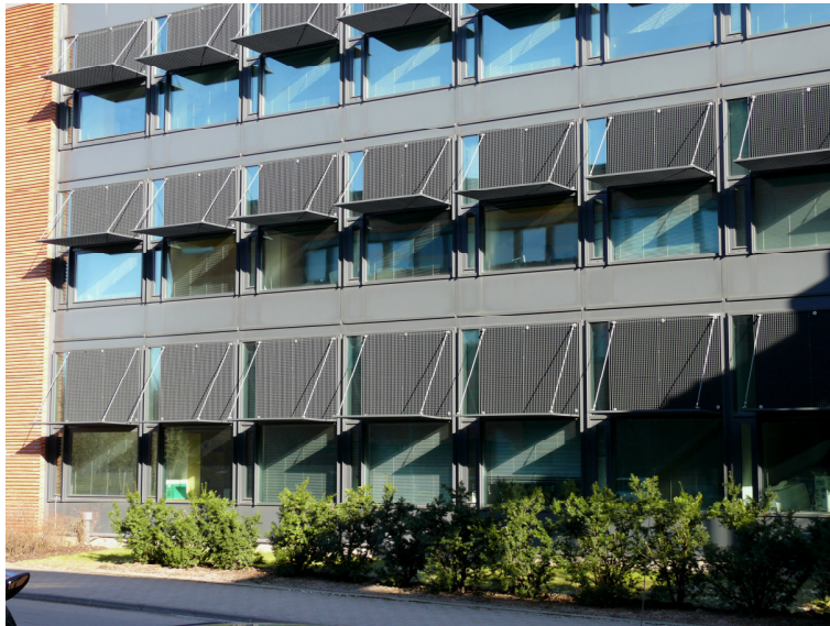
Kuva 11. Auringon säteilyn aiheuttaman ylikuumenemisen torjumisen ulkopuolisten ritilöiden avulla. TKK Tietotekniikan talo, Espoo.
