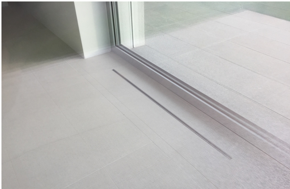
Slika 37: Primer vgradnje linijskega difuzorja LD-15, ki je lasten razvoj, v praksi
