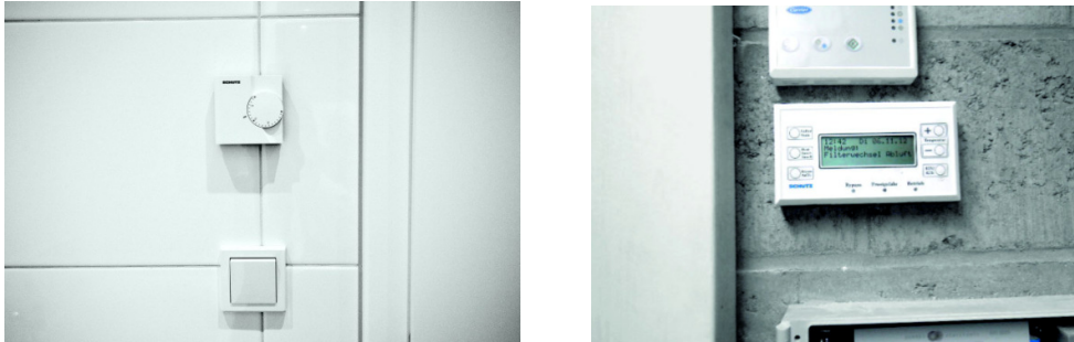
Slika 18: Sobni termostat in regulacija prezračevalne naprave[6]
