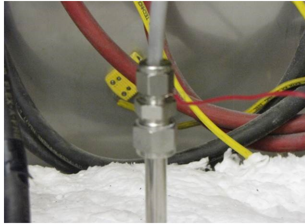
Figure A.11 Tuyau de gaz inerte fixé avec la mise à la terre connectée.
