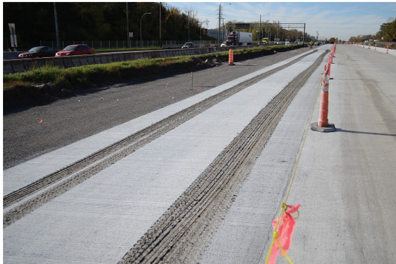
Figure 3.12 Partie gauche de la chaussée endommagée
