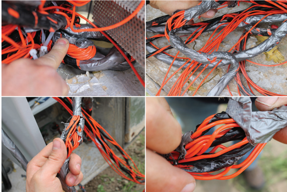
Figure 3.14 Endommagement des capteurs à fibres optiques
