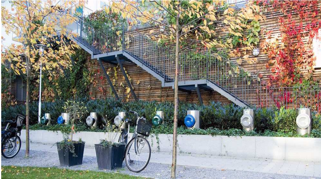
Figure 3.4 Système de collecte des matières résiduelles par aspiration implanté dans l'écoquartier Hammarby Sjöstad (tiré de ENVAC, s. d.)
