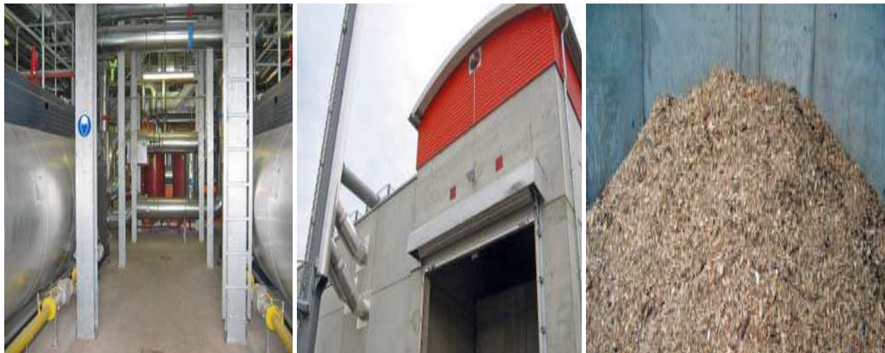
Figure 3.6 Centrale de cogénération de Fribourg-en-Brigau, desservant le quartier Vauban en chaleur et en électricité (tiré de ARENE Île-de-France, 2005)
