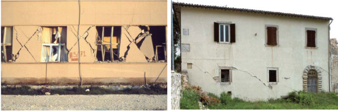
Figure 2.3 – Exemples typiques de rupture en cisaillement après un séisme [64]
