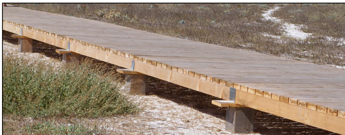
Passerella sopraelevata ideale per l'accesso all'arenile (Foto da www.reamarinasinis.it ).
