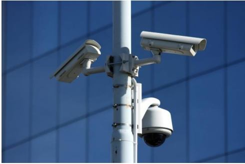
Figura 18 Telecamere di sorveglianza.
