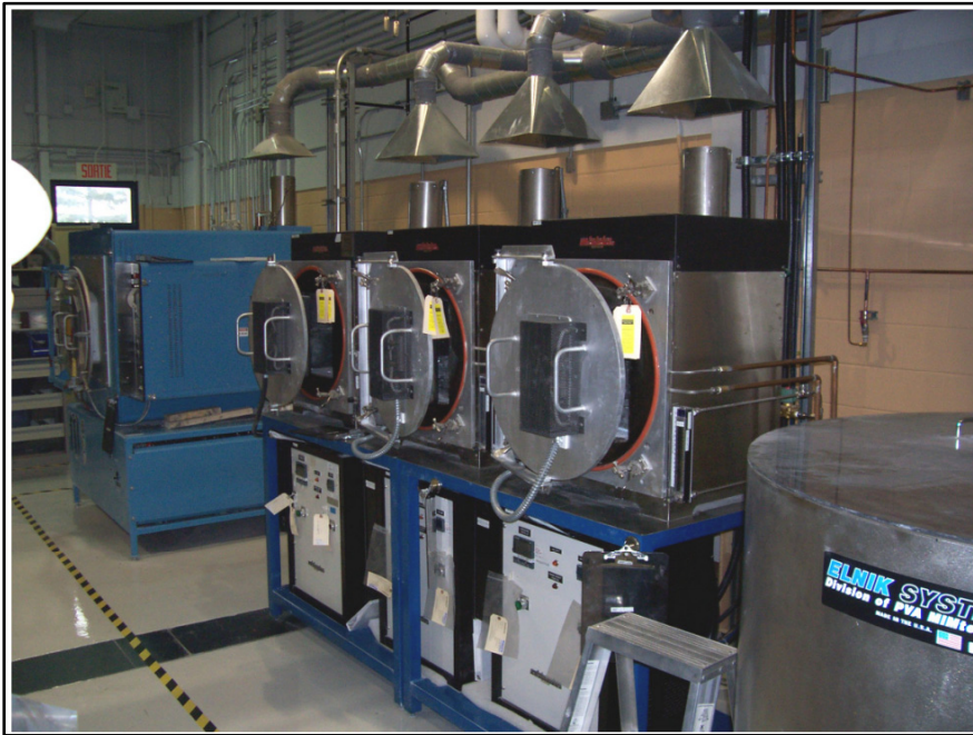
Figure 1.7 Photo des fours de déliantage (Ste-Marie, 2009)
