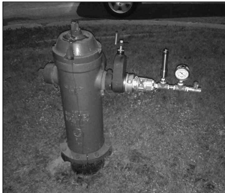
Figure 3.17 Manomètre et enregistreur de données installés sur le poteau d'incendie situé le plus près du point représentatif de zone du secteur résidentiel étudié de Saint-Jean-sur-Richelieu
