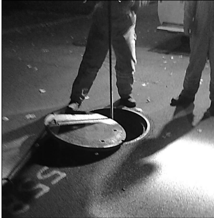
Figure 3.18 Fermeture de l'une des trois vannes pour isoler le secteur à l'étude
