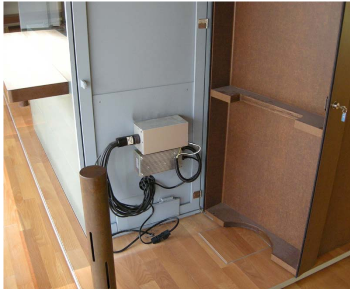
III. 30 Position du transformateur de l'éclairage à fibres optiques dans les vitrines d'exposition du Laténium avant installation de l'éclairage LED (©Laténium, 2011)
