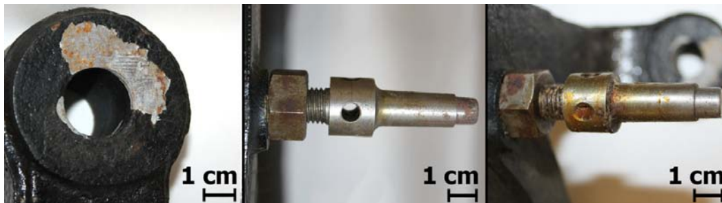
Figure 51 : Peinture écaillée et produit de corrosion brun ; tige de fixation recouverte de piqures de corrosion brune ; tige enduite de graisse.
