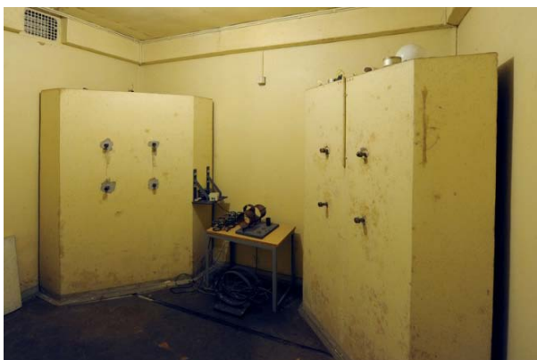
Figure 3 : Salle des horloges fondamentales située au sous-sol du Pavillon Hirsch.
