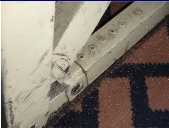
Figure 6 Pertes de revêtement de l'ossature en métal
