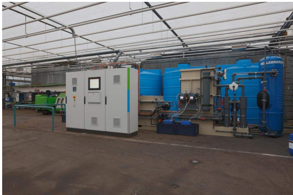
Figuur A-4 Aanzicht op gehele installatie.
