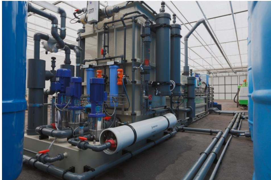
Figuur A-5 Aanzicht met omgekeerde osmose (RO) eenheid (onder) en AOP unit (boven).
