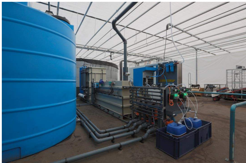
Figuur A-2 Tussenaanzicht onderzoeksinstallatie.
