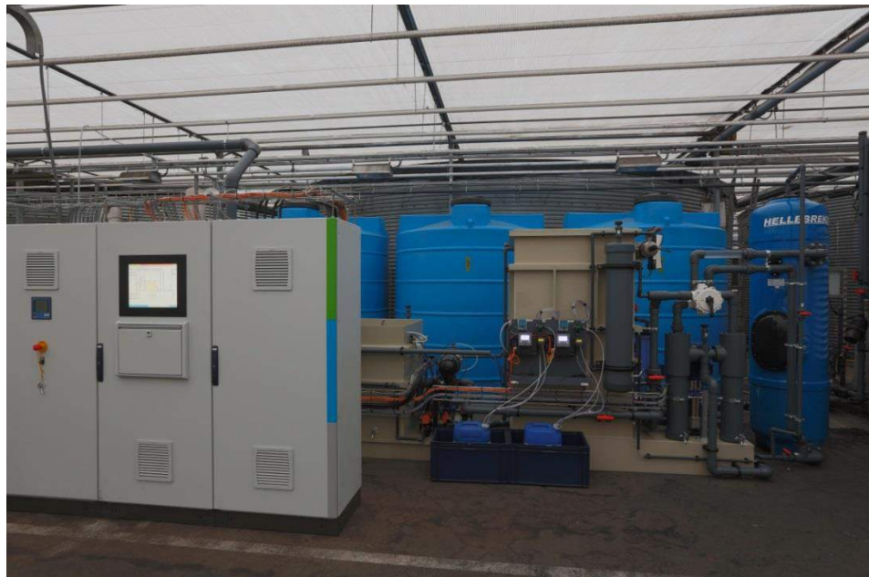
Figuur A-6 Zijaanzicht met regelkast (links), tussenopslag (midden) met AOP daaraan bevestigd en installatie voor actief kool (rechts).
