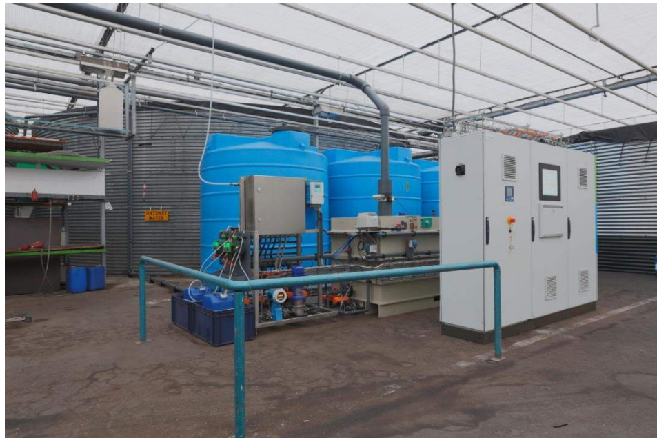
Figuur A-1 Vooraanzicht onderzoeksinstallatie industrieel onderzoek Goed Gietwater. Links voor de drie blauwe voorraad reservoirs is de pH correctie en een deel van de elektrocoagulatie eenheid zichtbaar.
