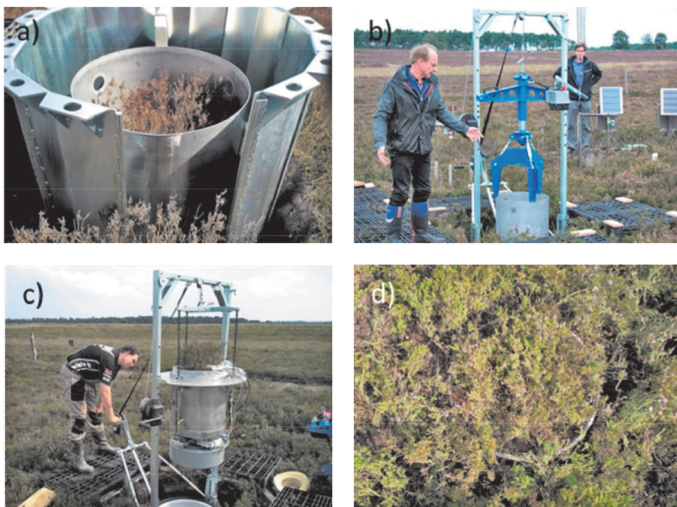
Afbeelding 11: a) damwandconstructie en steekring aan het begin van de installatie, b) pers voor het steken van een ongestoorde grondkolom, c) hijsinrichting om de lysimeter op te takelen en af te monteren, d) lysimeter na installatie.
