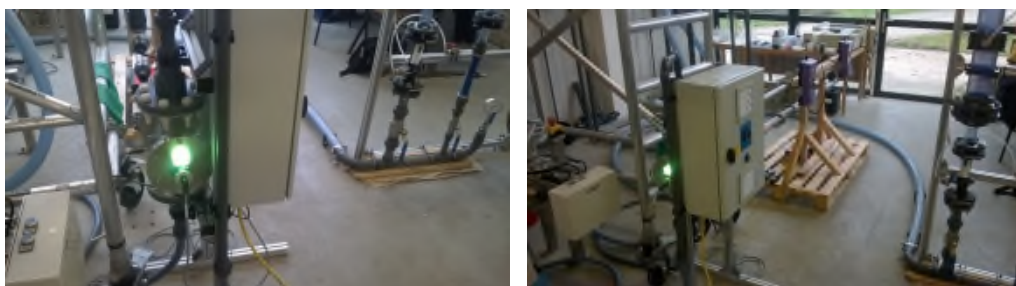
FIGUUR V-2 UV-INSTALLATIES
