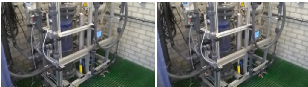
FIGUUR V-1 OZON INSTALLATIE
