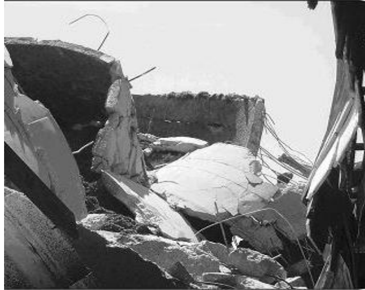
Figure I-4 : Effondrement d'un silo (Rylett 2008)
