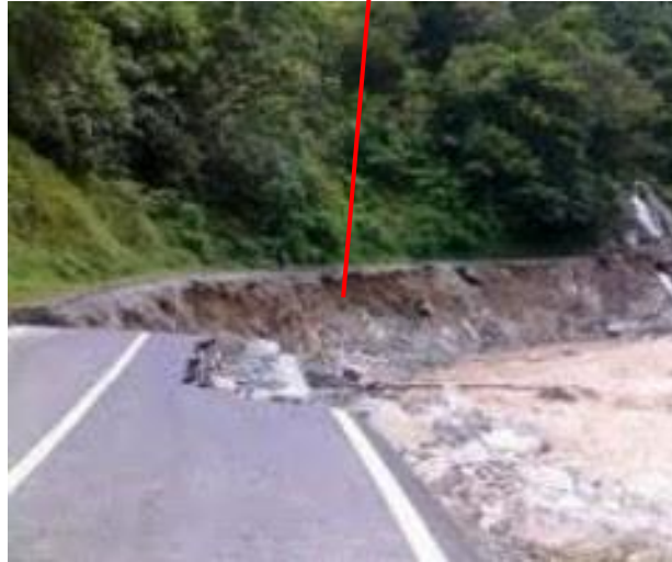
Gambar 2.2 Erosi yang terjadi akibat aliran sungai yang deras
