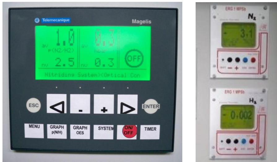
Figura 3.18 Unidad de control de presión de gases.
