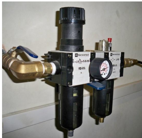
Figura 3.64 Unidad de mantenimiento ubicada en la toma de aire.
