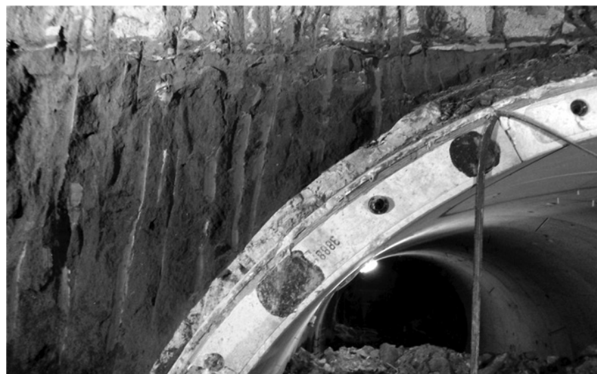
Fig. 2. Hardened two component mix below the segments and the soil as shown in the excavation of the station Centocelle. (photo Mapei's archive). Miscela indurita tra i conci ed il terreno come appare nello scavo della stazione di Centocelle (fotografia archivio Mapei).
