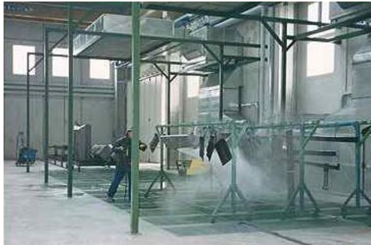
Figura 2.2: cabina di lavaggio (Immagine stratta da: http://tecnovamonteviale.beepworld.it/files/arealavaggiomanualer.jpg )
