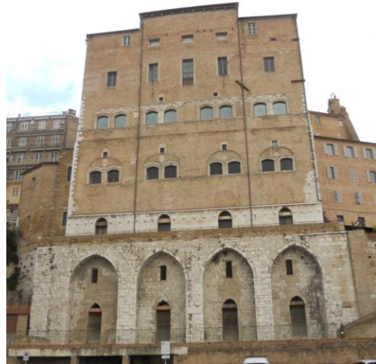
226 Il fronte del Palazzo che affaccia verso il porto e il mare. (Foto 2016)
