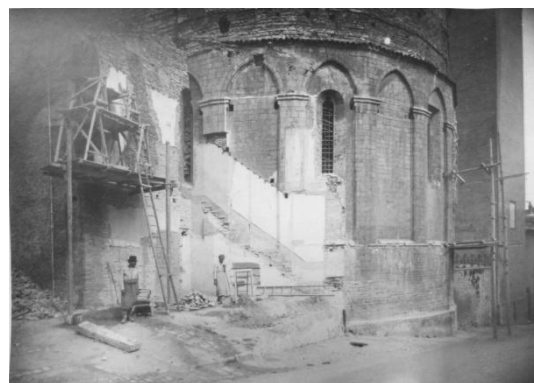
64 Lavori di demolizione dei corpi addossati all'abside. (da BCF, Icilio Bocci, Restauro della Cattedrale di S. Venanzo e del Palazzo Vescovile di Fabriano )
