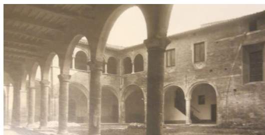
69 Termine dei lavori con le due arcate riaperte. (da BCF, Icilio Bocci, Restauro della Cattedrale di S. Venanzo e del Palazzo Vescovile di Fabriano )
