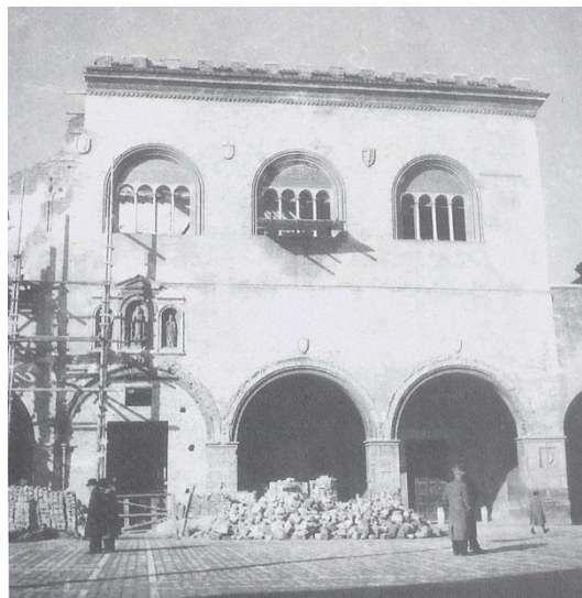
247 Immagine della facciata squarciata dai crolli con i ponteggi posti nella zona inferiore della torre. (da Ferri 1995, p. 247)
