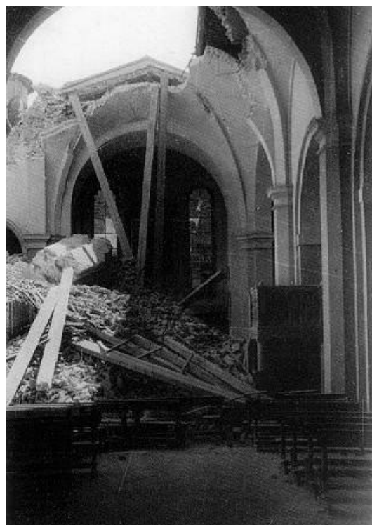
252 Veduta alla navata centrale verso il presbiterio con la copertura squarciata dal crollo del campanile. (da http://www.fondazioneclarifano.it/Progetti/giornale_fano_liberata/fano_liberata_strage_campanili.pdf )
