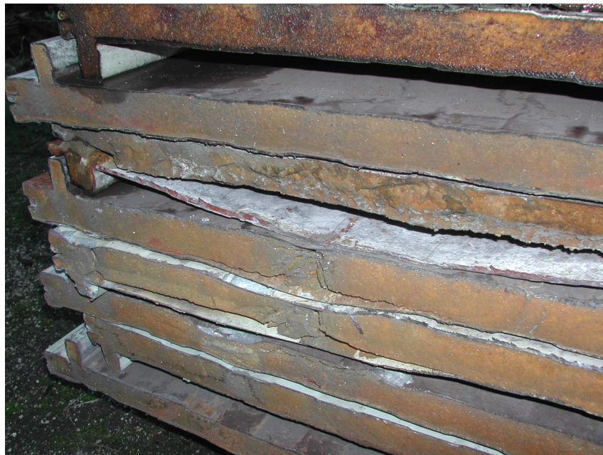
Figura 1.6. Detalle del estado de deterioro de los paneles. Fotografía tomada inmediatamente después de ser retirados de su ubicación.
