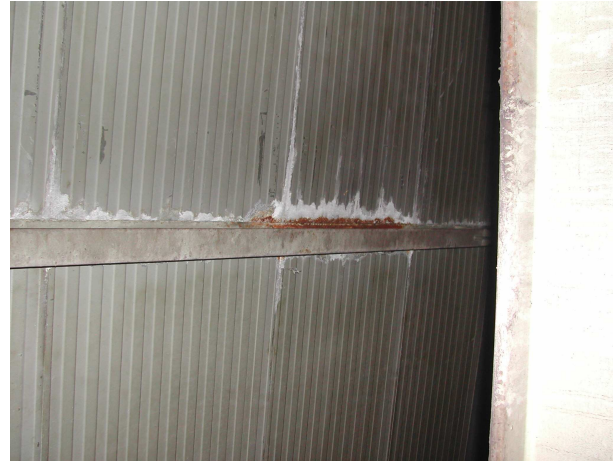
Figura 1.5. Vista interior. Deterioro del panel en su apoyo sobre la correa
