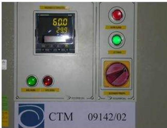
Figura 3.16. Detalle del controlador de humedad y temperatura de la cámara climática
