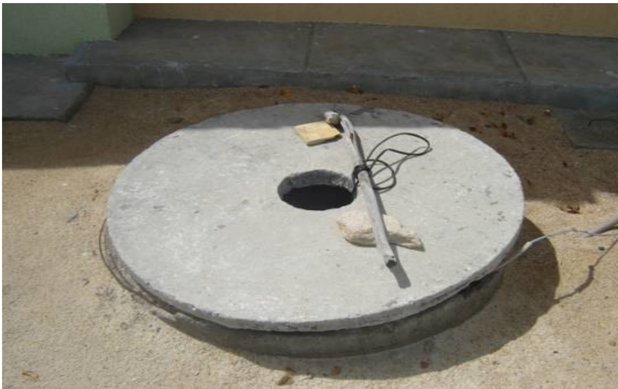
Fotografia 36 – A imagem mostra o sistema rudimentar de abastecimento de água com a utilização de poço, a captação é feita manualmente e com o uso de bombas hidráulicas elétricas, Galinhos-RN (Foto: Adriana Rocha, novembro/2006).
