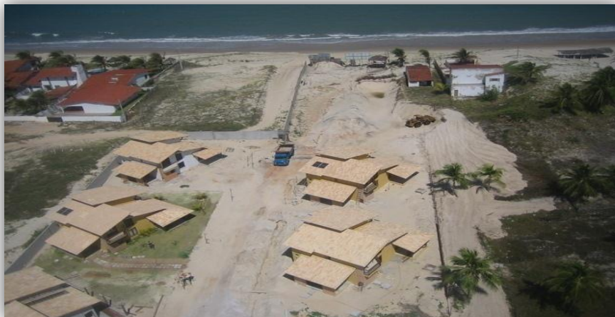
Figura 51 – Praia de Jacumã (Ceará Mirim). Obras do Jacumã Beach and Golf Village iniciadas. No primeiro plano é possível observar os vizinhos do condomínio, implantados de forma tradicional no lote, nos anos de 1980.
