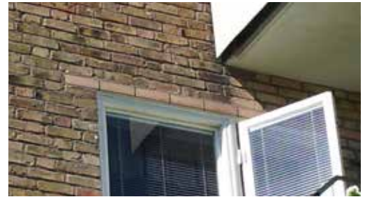
En fasad med nya tegelstenar. Foto: Angela Sasic Kalagaidis
