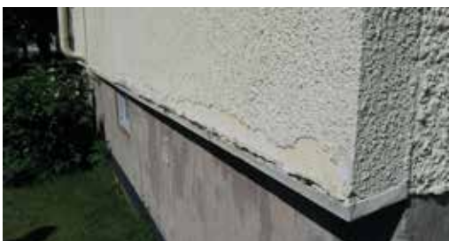
En stor fuktskada pga att plåten samlar upp vatten.
