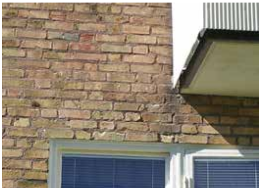
Vattnet rinner från balkongen ner på tegelfasaden.
