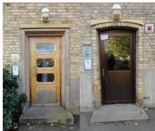
En original och en utbytt entrédörr. Foto: Annika Danielsson
