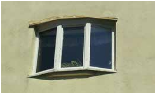
En utsatt och vattenskadad detalj ovan burspråket.
