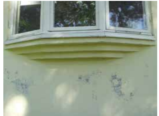
Ommålad fasad där färgen lossnar under burspråket
