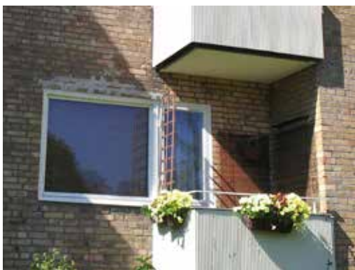
Synliga lagningar från en vattenskada över fönstret.
