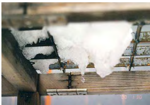
図 2-9 格子から雪が垂れ下がっている様子 於栃尾市原町 H12.1.30
