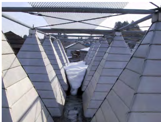
図 5-3 地上の積雪が 49cm の時の積雪の様子 H16.2.21 於栃尾市原町 エキスパンドメタルをピラミッド型屋根の上に並べる ことにより、通路の雪 80cm が完全に融けた。
