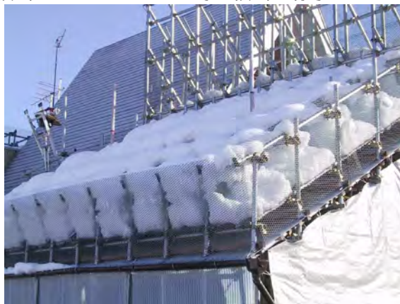
図5-22 地上の積雪が100cmに減少した時の積雪の様子 H16.2.11 於栃尾市原町
