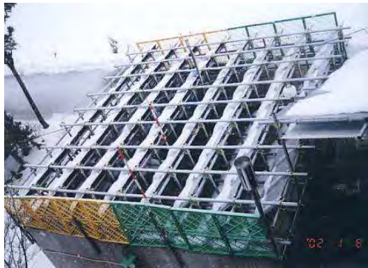
図 2-57 北側の鉄筋 1 列目が殆ど露出した様子 地上 30cm H14.1.8
