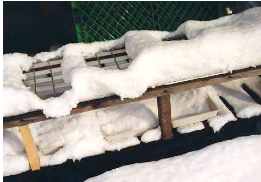
図 2-12 格子から雪が抜け落ちている様子 於栃尾市原町 H12.2.2
