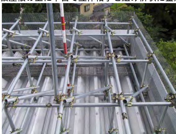
図 5-13 複式折板屋根の上に単管で立体格子を組み斜材を入れて積雪層を不安定にした様子
