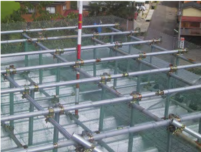
写真 4 複式折板屋根の上に単管で立体格子を組み柵状に金網で囲った様子
