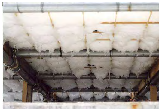
図 2-35 垂れ下がった雪に小さな氷柱が発生し融けている様子 H12.1.30
