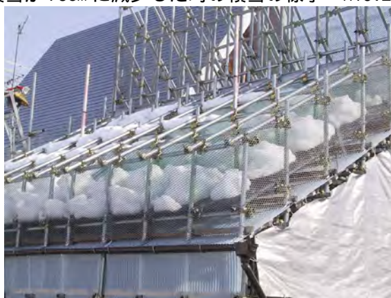
図 5-24 地上の積雪が 75cm に減少した時の積雪の様子 H16.2.14 於栃尾市原町
