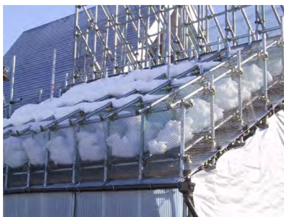
図 5-23 地上の積雪が 78cm に減少した時の積雪の様子 H16.2.13 於栃尾市原町
