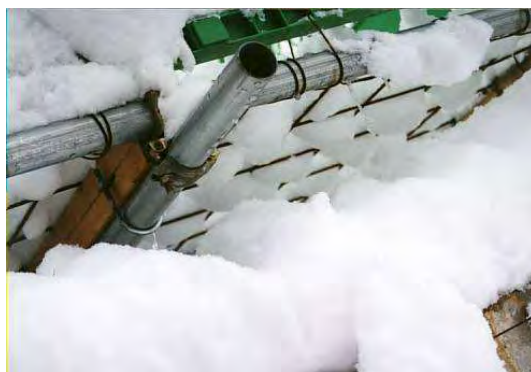
図 2-30 新雪が被さり少し垂れ下がっている様子 H12.1.28
