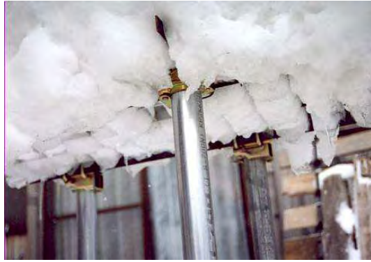
図 2-15 格子から雪が垂れ下がり出している様子 H12.2.22
