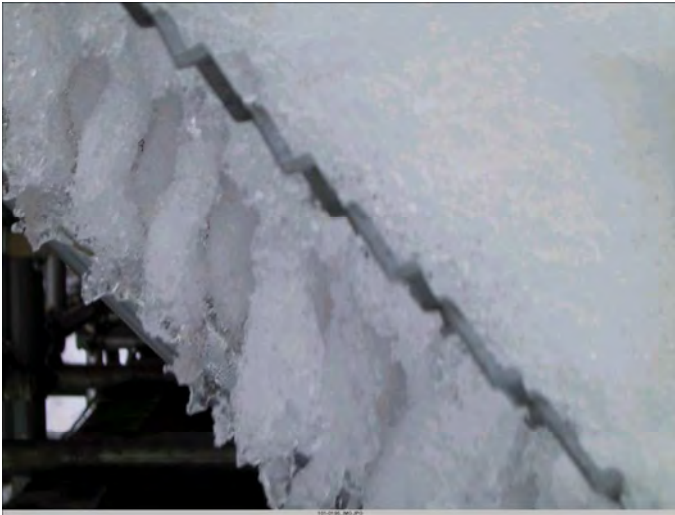
写真9 鉄パイプの外から雪が垂れ下がった様子H14.2.16
