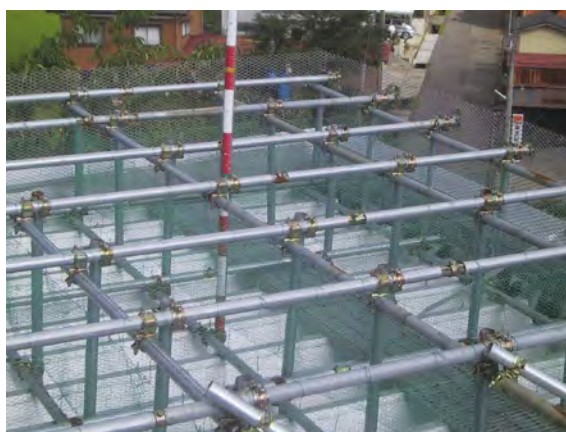
図 5-12 複式折板屋根の上に単管で立体格子を組み柵状に金網で囲った様子
