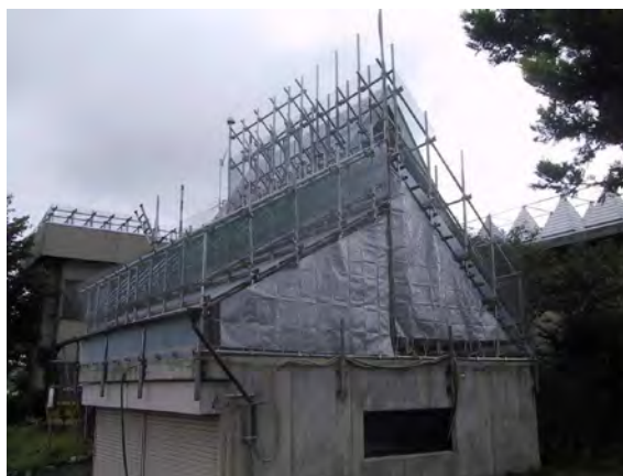
図 5-22 車庫の屋根に設置した 30° と 45° の実験屋根
