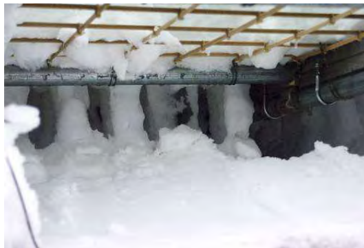
図 2-38 新雪がFRPグリッドに被さり下まで垂れ下がっている様子 H12.3.11
