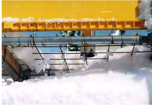
図 2-33 筒の周りの雪が融け周辺に雪が垂れ下がっている様子 H12.2.26
