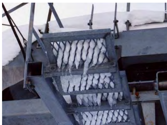
図 1-30 エキスパンドメタルから無数に垂れ下がった雪の房 奥只見丸山スキー場のリフトの点検足場 H12.1.3
