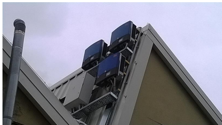
Slika 9: Razsmerniki na fotonapetostni elektrarni Iskra v Kranju
