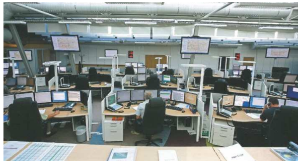
Figure 4 : Vue à l'intérieur du CNOF (Source : Revue Générale des chemins de fer, février 2010, n°191)
