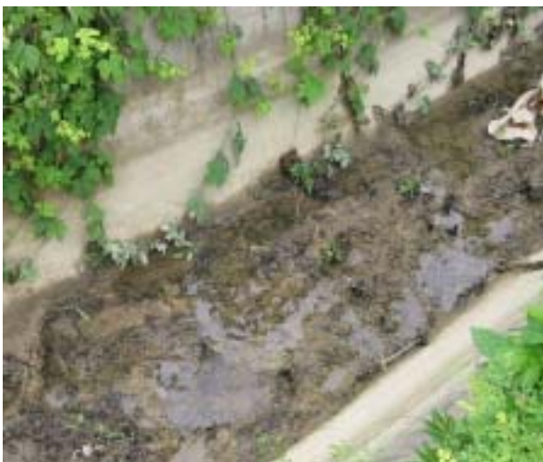
Abb. 15: Schwermetallhaltige Sedimente lagern sich als Schlamm in den Bewässerungskanälen ab.
