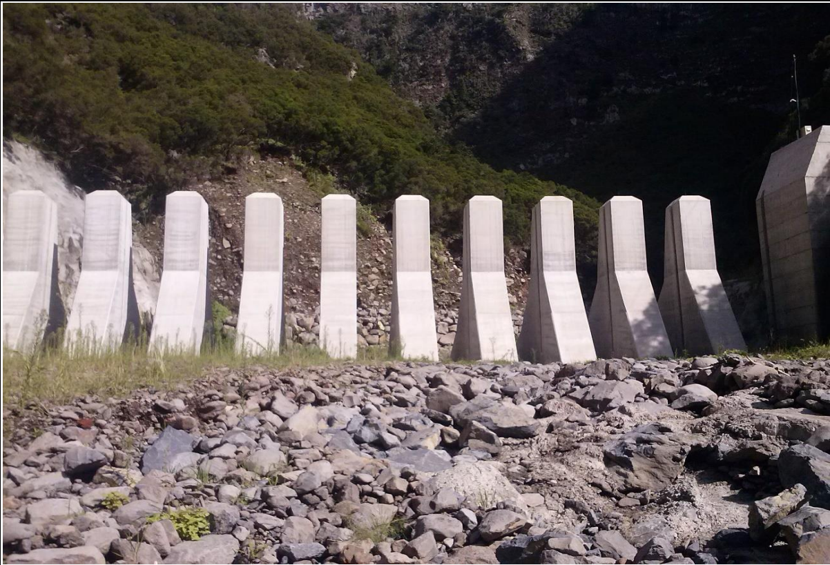
Figura A4.7: Tapete de enrocamento a jusante
