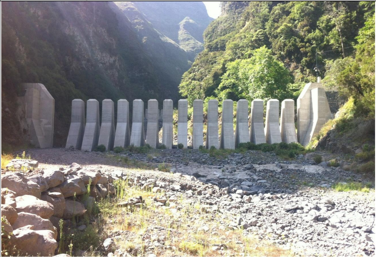
Figura A1.7: Tapete de enrocamento a jusante
