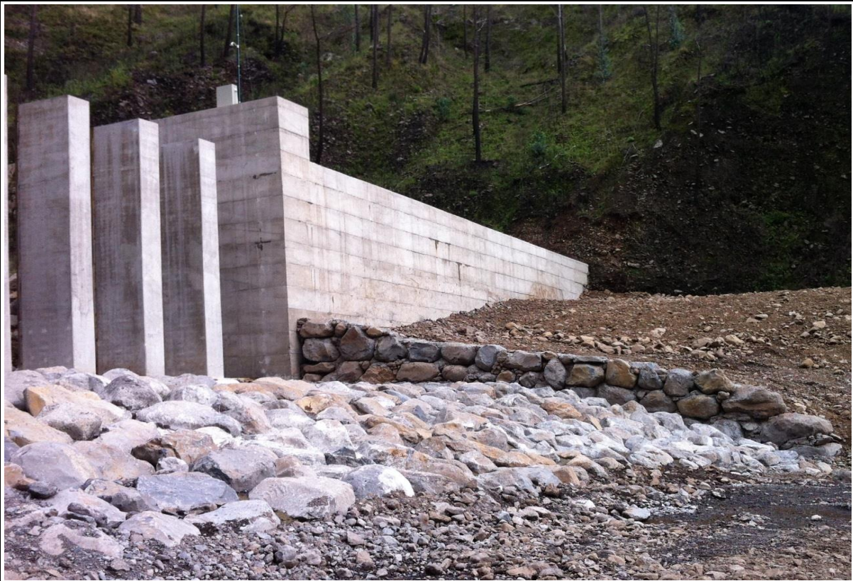
Figura A6.8: Tapete de enrocamento a jusante
