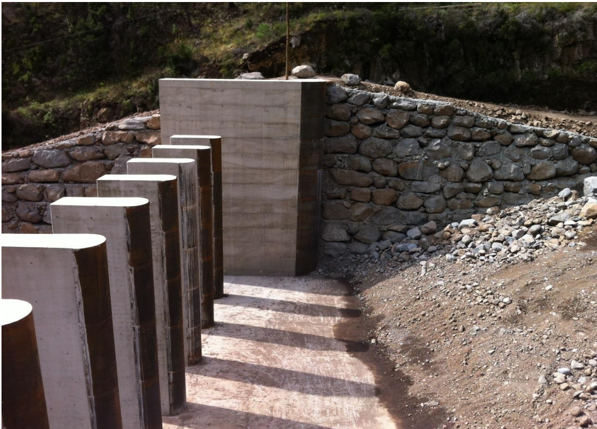
Figura A5.7: Acesso pela margem direita. Proteção a montante com chapas metálicas
