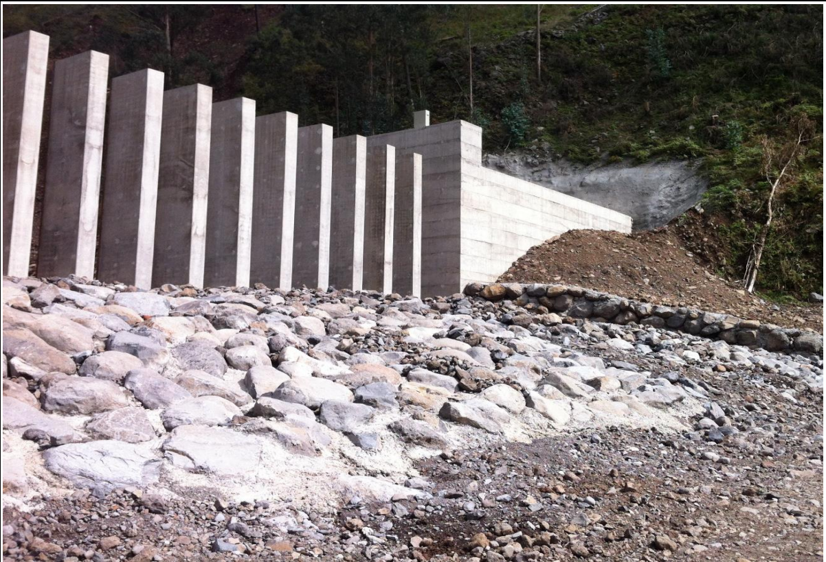
Figura A7.8: Tapete de enrocamento a jusante
