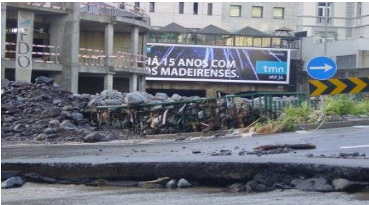
Figura 1.7: Infraestrutura destruída ( http://www.meteopt.com )
