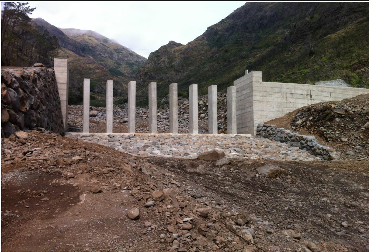
Figura A5.8: Tapete de enrocamento a jusante
