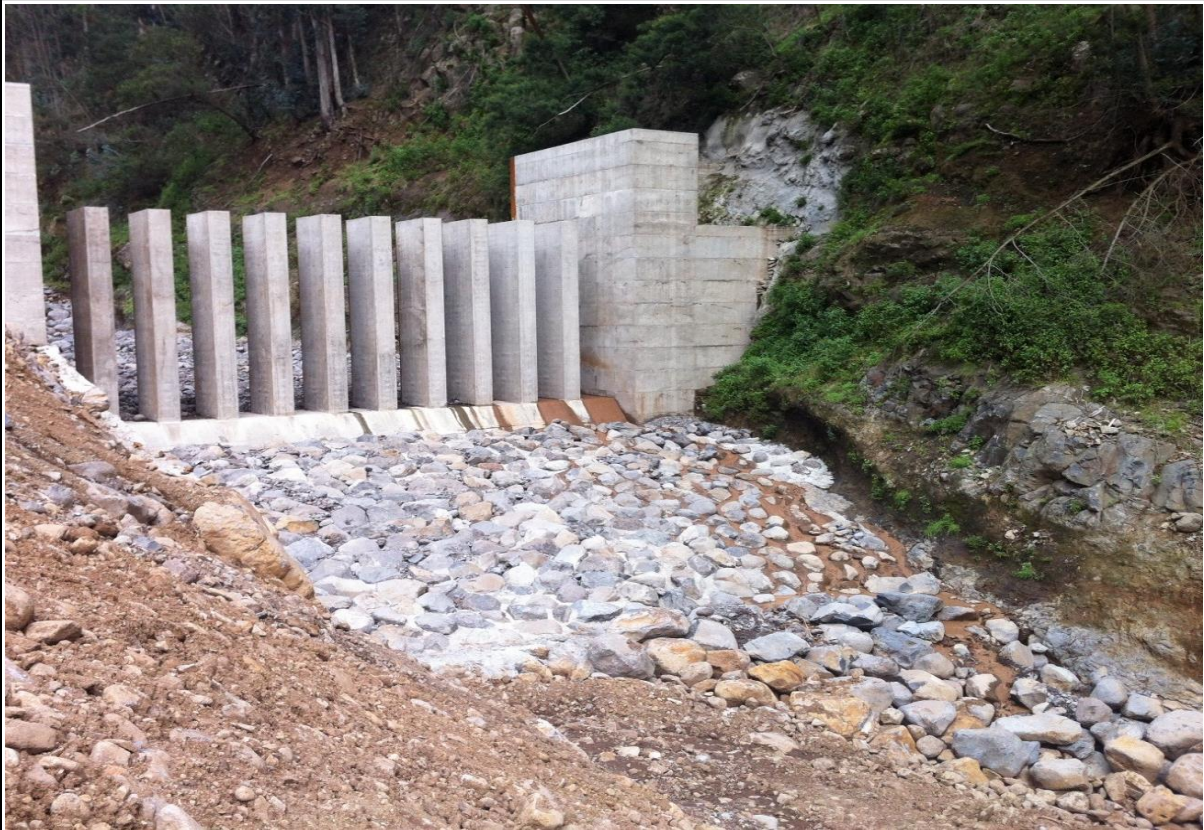
Figura A8.8: Tapete de enrocamento a jusante
