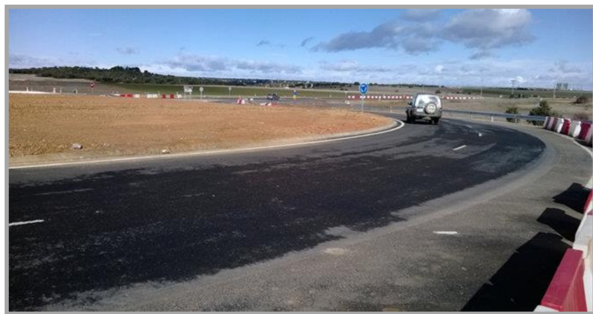
Fotografía 1: Rotonda PK 0+000 de la N-631 que da acceso a la A-66. Punto de inicio de la Alternativa -1 y la Alternativa -2
