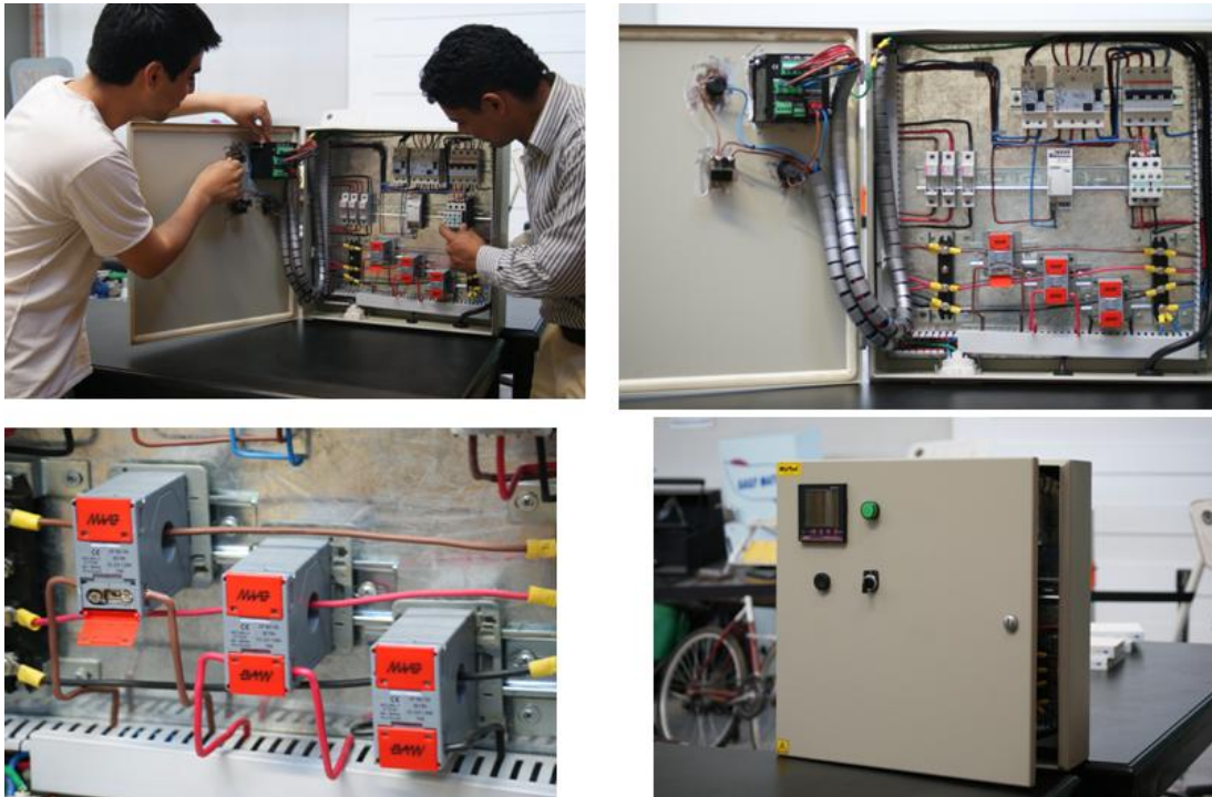
Figura 4: Instalación definitiva del analizador de redes
