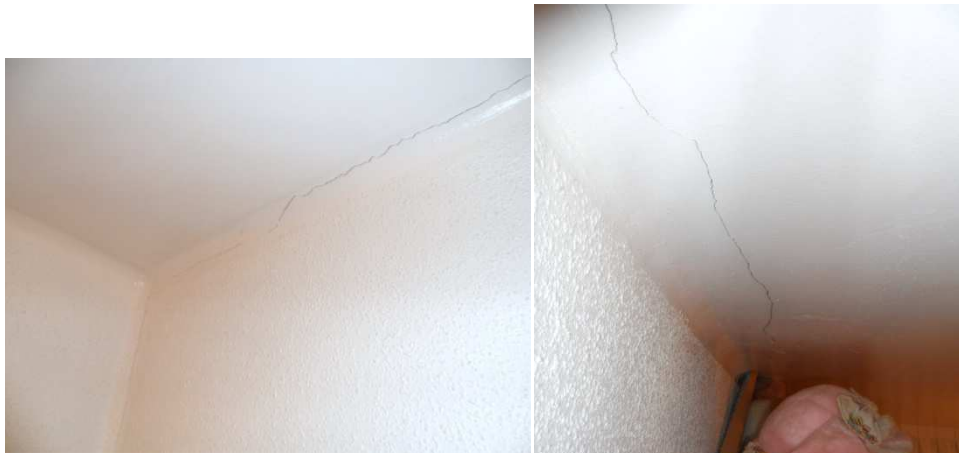
Imagen 3.8 Grietas en forjado
