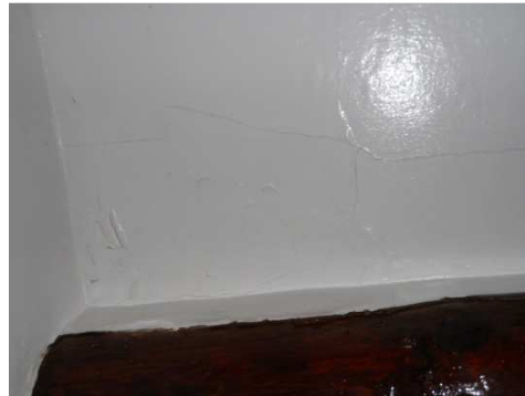
Imagen 3.10 Fisuración del acabado
