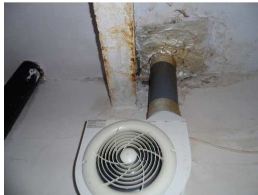
Imagen 3.12 Humedades por filtración
