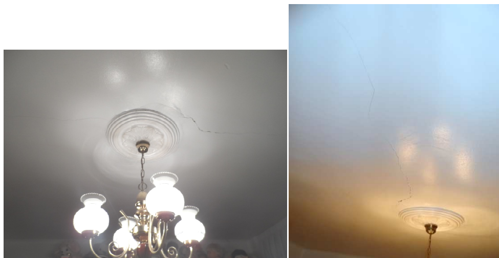
Imagen 3.13 Fisuras en forjado de cubierta
