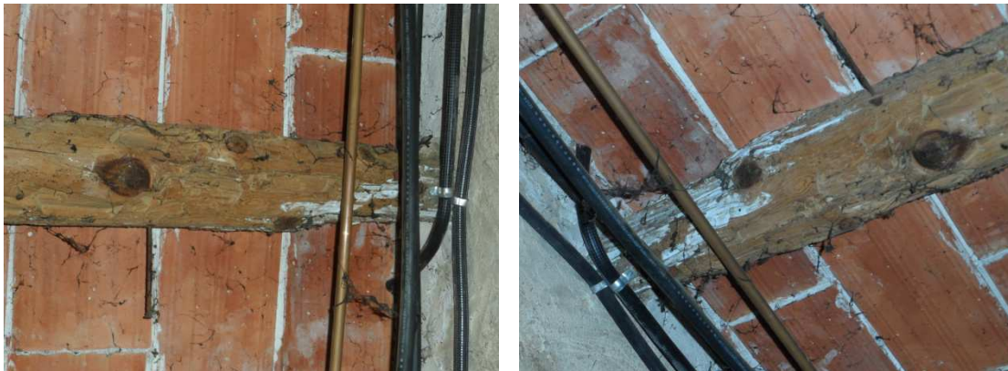
Imagen 3.14 Perdida de sección en Viguetas 12 y 13
