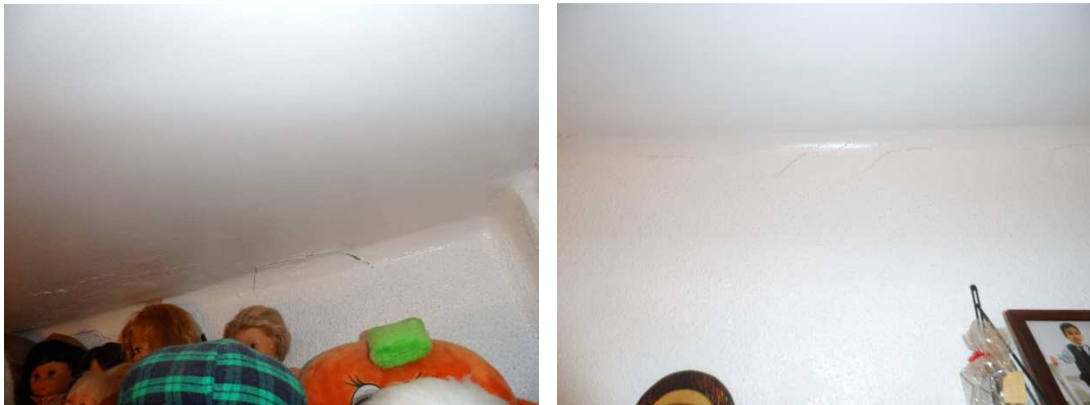
Imagen 3.9 Fisuras encuentro forjado y muro
