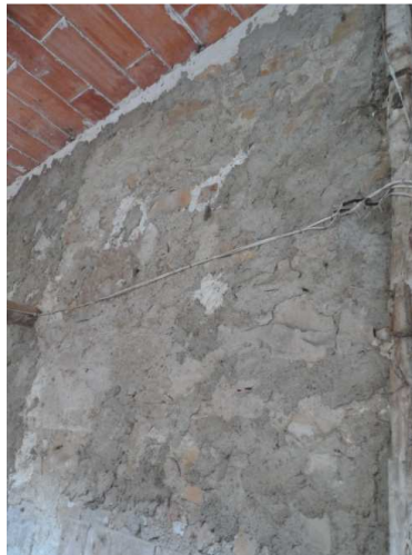
Imagen 3.24 Desprendimiento Fachada posterior
