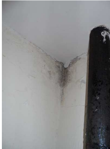
Imagen 3.3 Humedades Planta Segunda
