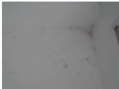
Imagen 3.2 Humedades Planta Primera
