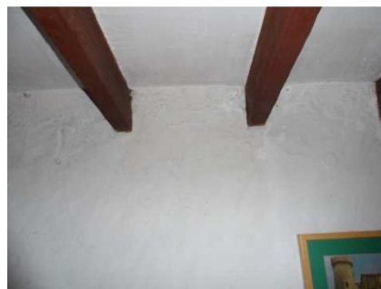
Imagen 3.4 Humedades Planta Segunda
