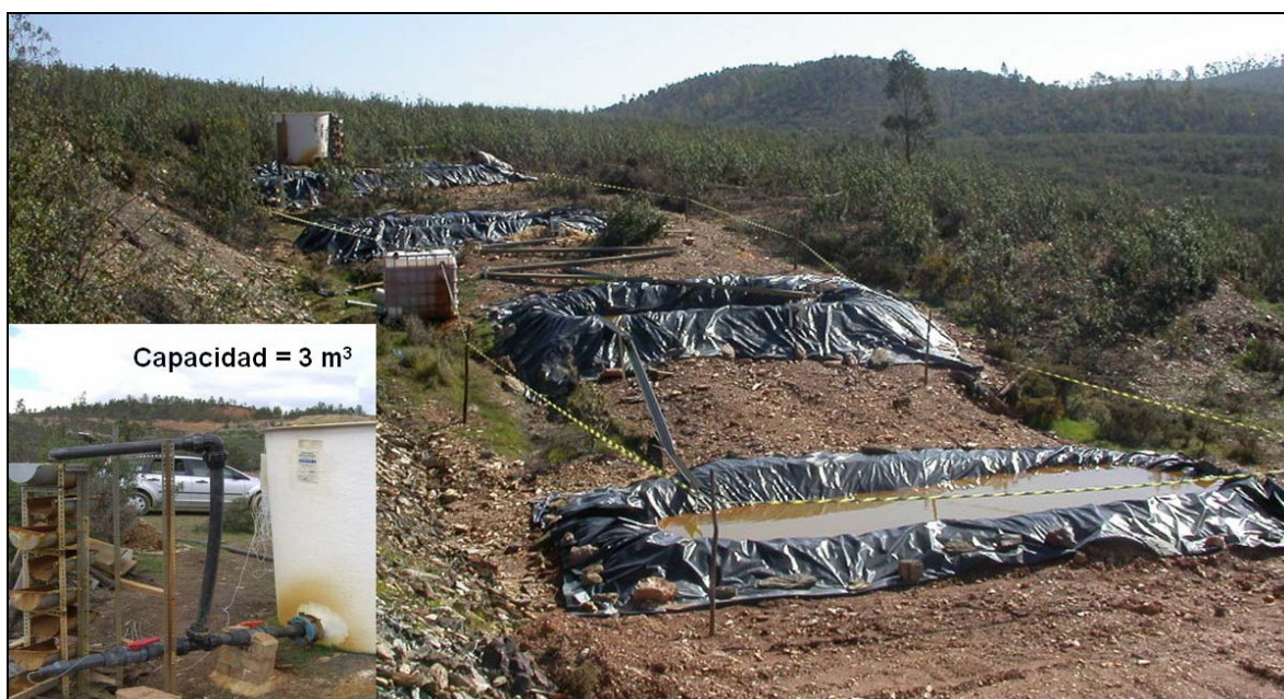
Figura 7.11: Planta de tratamiento de aguas ácidas a escala piloto ubicada en Cueva de la Mora.
