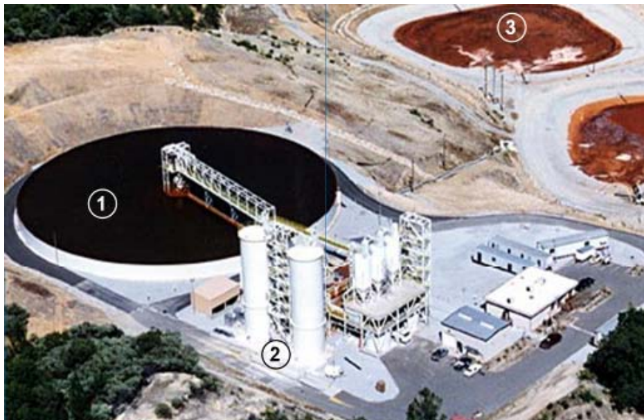
Figura 7.3: Planta de tratamiento activo situada en las inmediaciones de una instalación minera en actividad. (1) Tanque de aireación, (2) tolvas para la dosificación de alcalinos, y (3) balsas de decantación.
