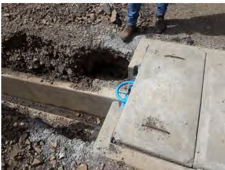
Foto 18: Cambio de infraestructura de tubería a canal en la progresiva de 10+000 que está ubicada en el centro poblado de Uranyacu.
