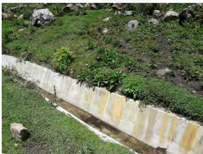
Foto 6: la reconstrucción del canal trapezoidal que está ubicada en el centro poblado de Santa Rosa. Además, se ve la parte vegetativa que acompañara en todo el tramo del sector 1.
