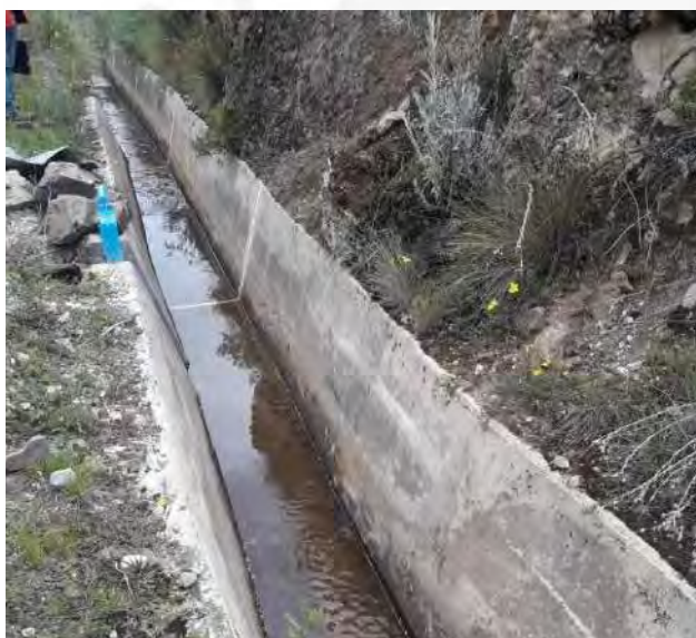
Foto 10: Reparación del canal trapezoidal que está ubicada en el centro poblado de Santa Rosa.
