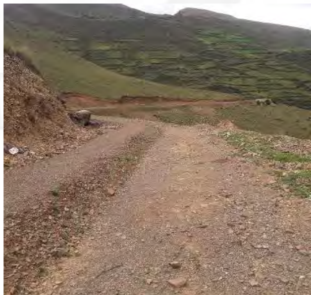
Foto 16: La colocación de tubería enterrada en toda la trocha que está ubicada en el centro poblado de Uranyacu. Además, se observa que el suelo esta removido y poca vegetación.
