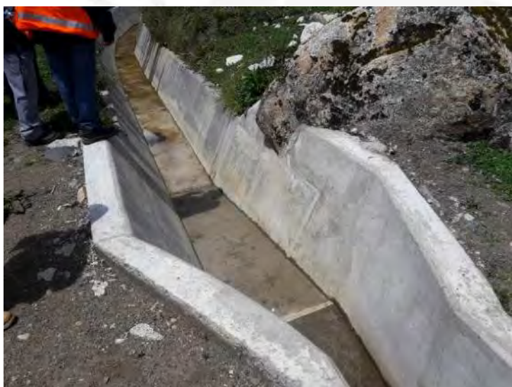
Foto 5: la transición del canal rectangular a trapezoidal que está ubicada en el centro poblado de Santa Rosa.
