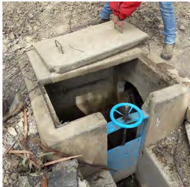
Foto 17: Compuerta para el desvío de agua hacia los cultivos y para la limpieza de tubería que está ubicada en el centro poblado de Uranyacu.
