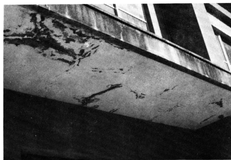
写真5 南出入口庇、ひびわれと雨水の浸透
