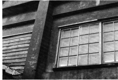
写真3 東面柱のたてひびわれ
