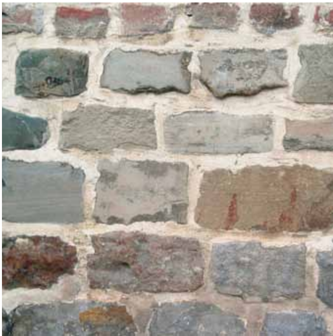
[5.21] Detail van de ondermuur van het zuidelijke gedeelte van het schip: drie rijen restauratiestenen uit bruingrijze, grijsgroene en bruine Famenniaan-zandsteen, boven Tiense kwartsiet (Roland Dreesen, 2006).
