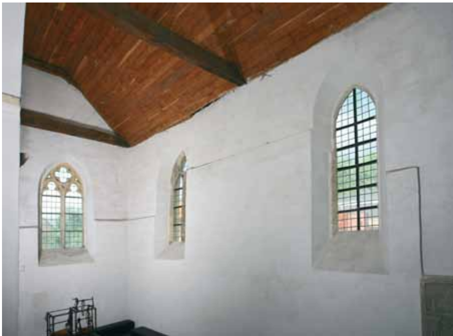
[6.5] Horizontale verspringsing en bouwnaad in de eerste traveeën van de noordelijke zijbeuk (VIOE, Kris Vandevorst, 2007).
