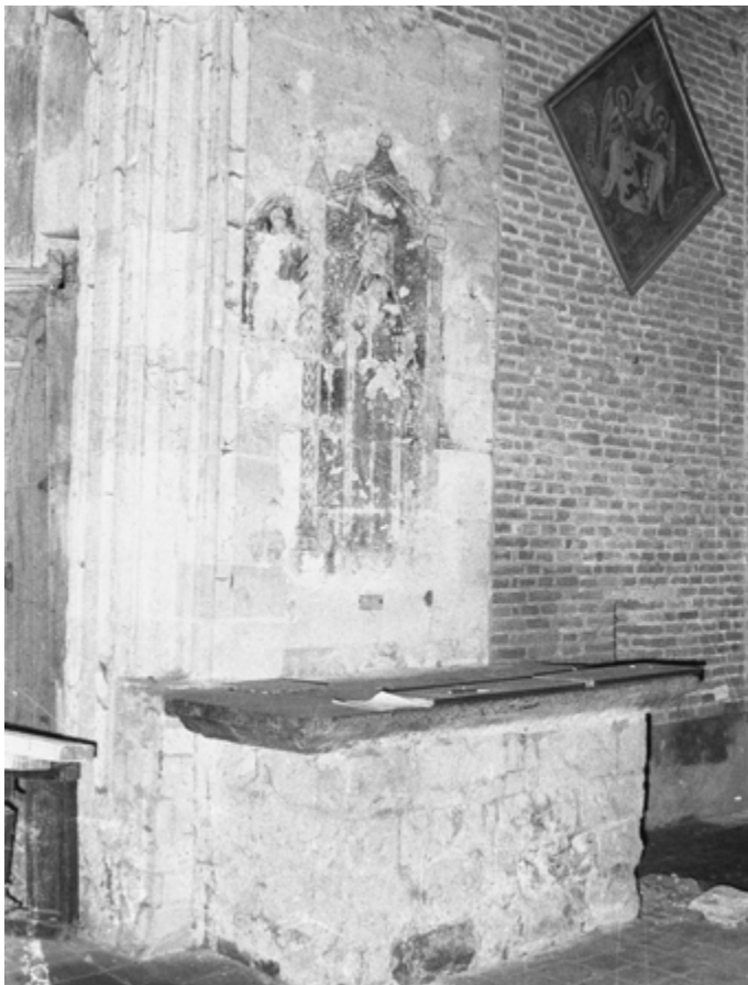
[6.21] Bouwnaad en duidelijk materiaalverschil tussen de triomfboog en de zuidelijke zijbeuk (PCCE, archieffoto).
