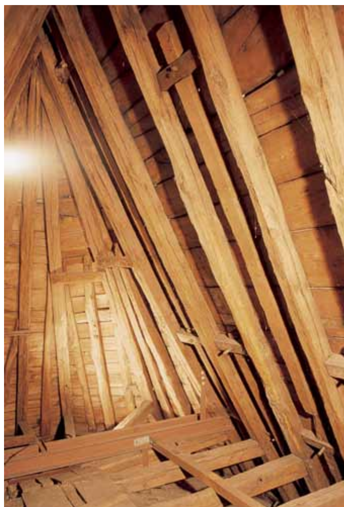
[6.28] Tussen de sporen werden keplers en halfhouts verbonden blokjes aangebracht om de dakkap te verstevigen (THOC, 2004).
