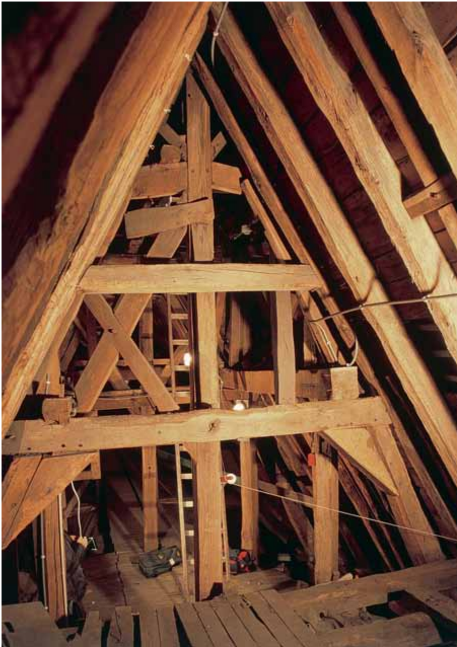
[6.40] Overgang tussen de verzakte sporenkap op het koor en de kap met de dakruiter op het oostschip (THOC, 2004).
