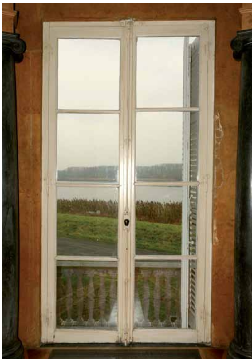
FIG. 13.32 Verzakking van het raam R202 door de gewichtstoename door de dubbele beglazing.
