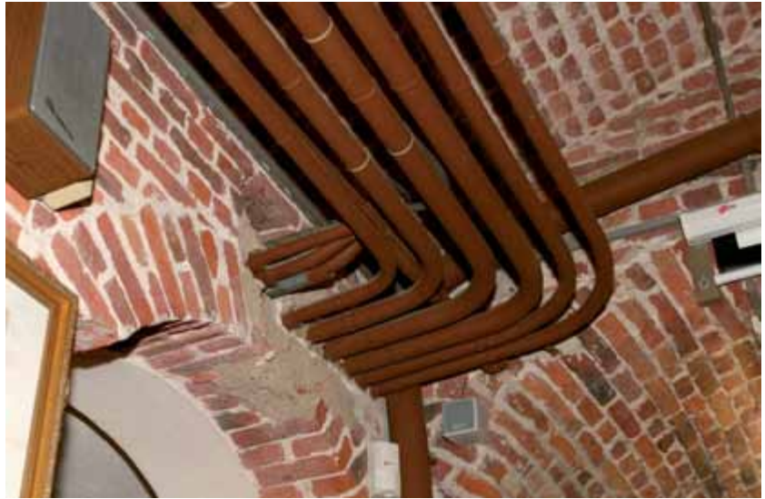
FIG. 13.35 Leidingen in opbouw in ruimte 003.
