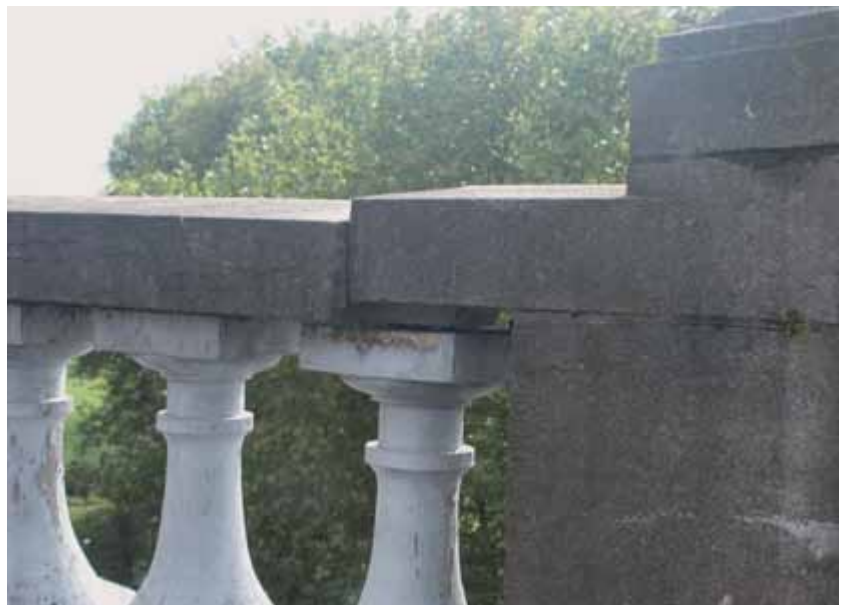
FIG. 13.22 Lichte verzakking van de handlijst (foto Willem Hulstaert, VIOE).
