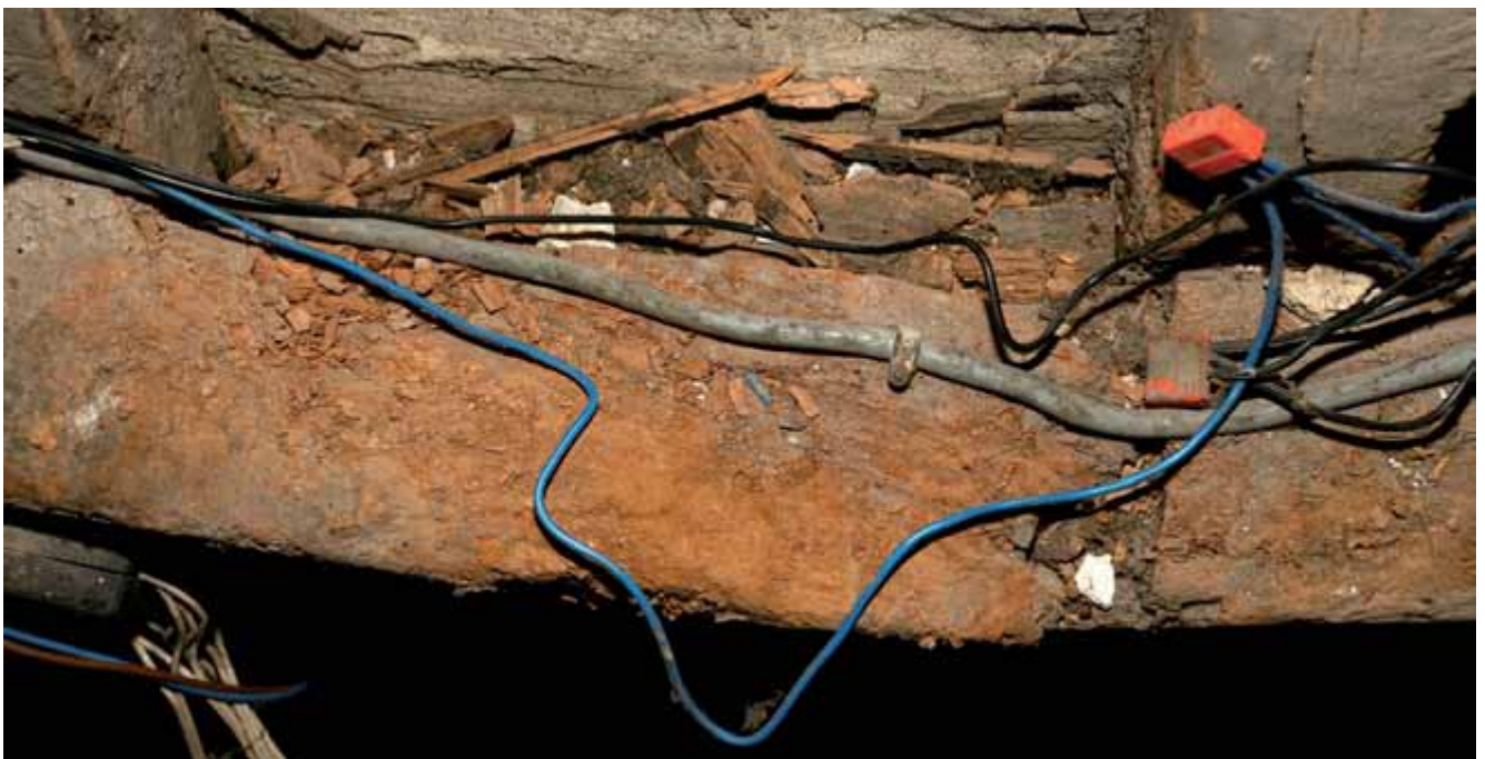
FIG. 13.40 Onzorgvuldige plaatsing van elektrische bedrading.
