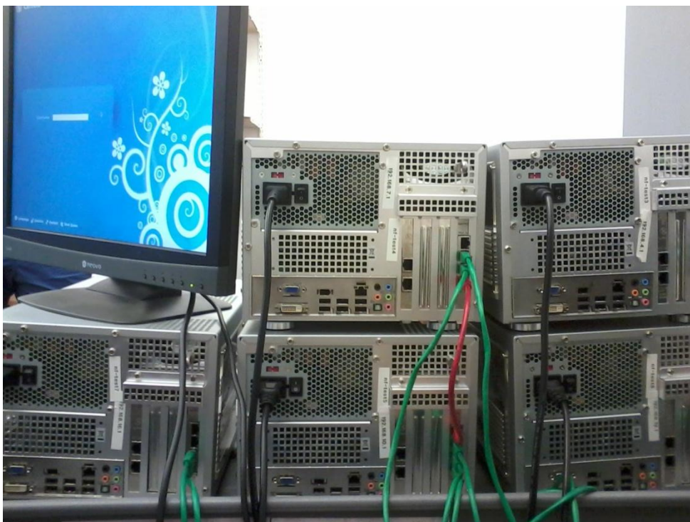
Figura 77. Algunos de los switches ARP-Path (cada switch es un PC con una tarjeta NetFPGA instalada en él) del montaje en malla realizado en el CCL
