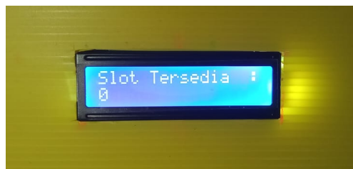
Gambar 4 Kondisi LCD saat Slot Parkir Tidak Tersedia
