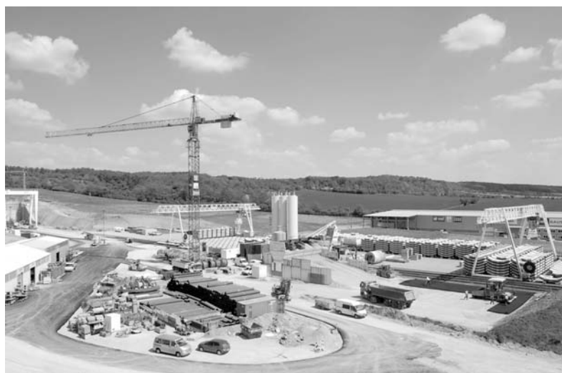
Abb. 5.7 Baustelleneinrichtung mit Feldfabrik für die Tübbingvorfertigung am Finnetunnel im Jahr 2008, WAYSS & FREYTAG Ingenieurbau AG (Foto: M. WILLE)
