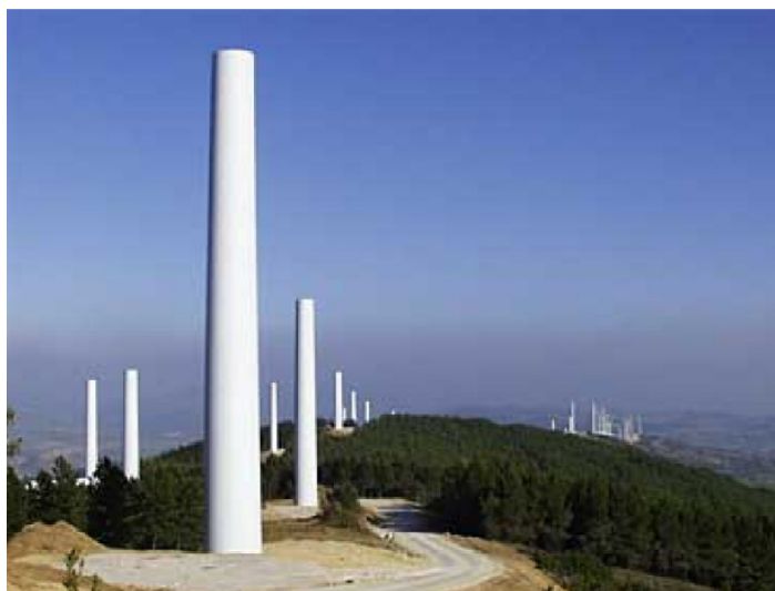
Fig. I.6. Pylône tubulaire d'un futur parc éolien [I.5].
